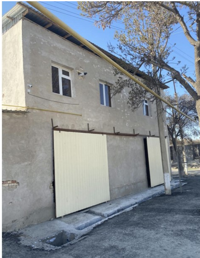
Rasm 5. Ma'muriy bino (2-qavat) va avtotota'mirlash ustaxonasi (1-qavat)ning umumiy ko'rinishi; Devorlar, derazalar va darvozalar konstruktsiyalarini tekshirishda hech qanday zarar aniqlanmadi
