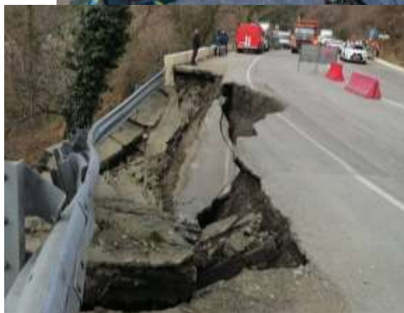
Рисунок-2. Оползания откосов насыпи автомобильной дороги.
